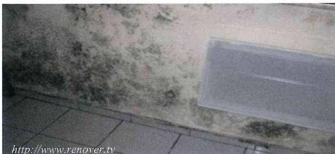
Traces sur le mur de la buanderie
