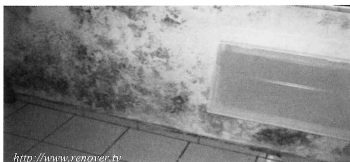
Traces sur le mur de la buanderie
